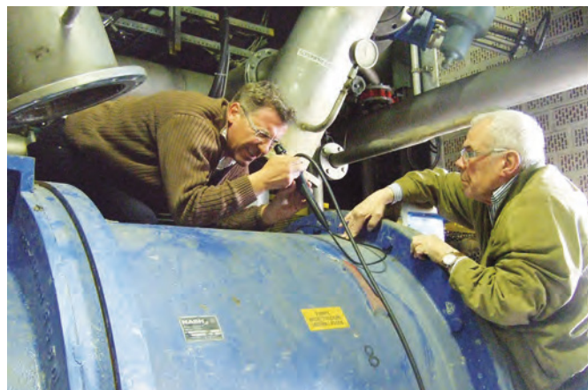
Vacuumpompspectie/-capaciteitstest ter plaatse door een Richter service technicus
