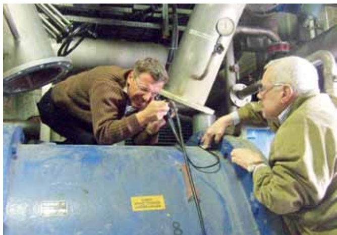
Analyse ter plaatse van een vacuümpomp door Richter onderhoudsmonteur. (hier Heinz Heilliger, links en H.F. Laub)
